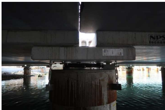
Appoggio travi con smorzatori sismici
